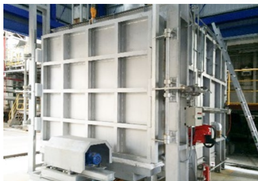
増設した固定床炉
